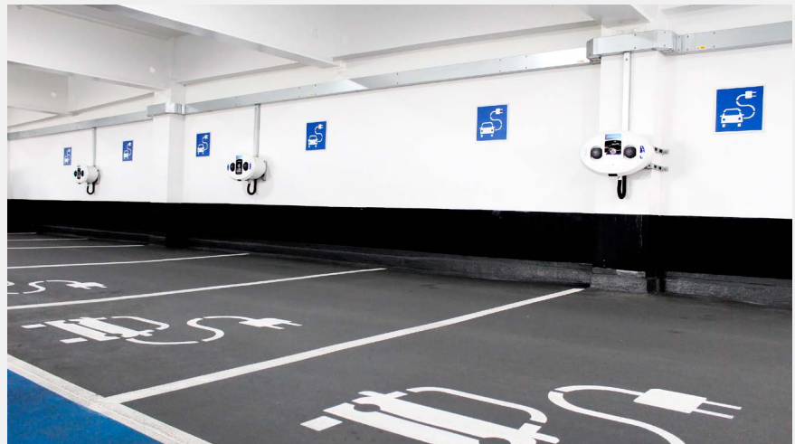
Para atender ao aumento previsto na utilização de VE, serão necessários vultosos investimentos em infraestrutura
